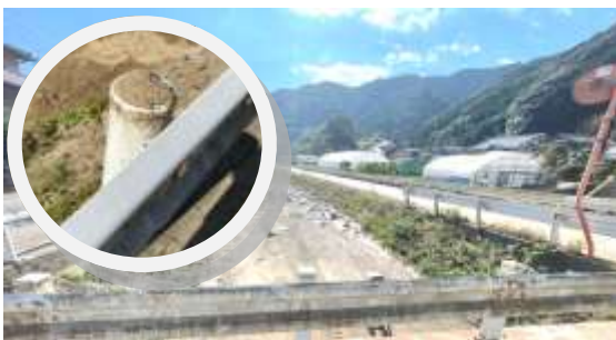
氾濫した川の現在の様子 丸写真はガードレールの上に積もったままの泥
